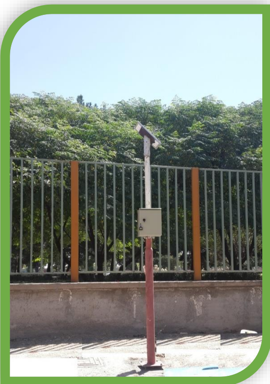
سنسور فشار آب منصوبه ورودی درب شمالی
