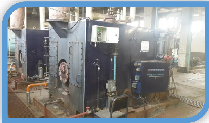
دیگ شماره ۲ موتورخانه مهندسی و فلومتر گازی به همراه تجهیزات قرائت
